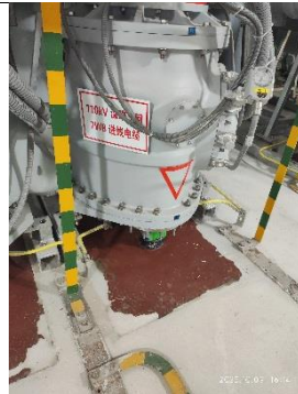
变电站进出线
